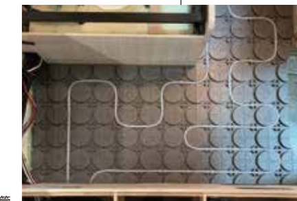
床下に施工された床暖房パネル・配管
